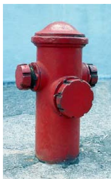
Fig. 04 – Hidrante Urbano de Coluna
