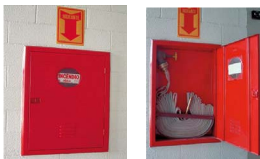
Fig. 12 – Caixa de Incêndio
